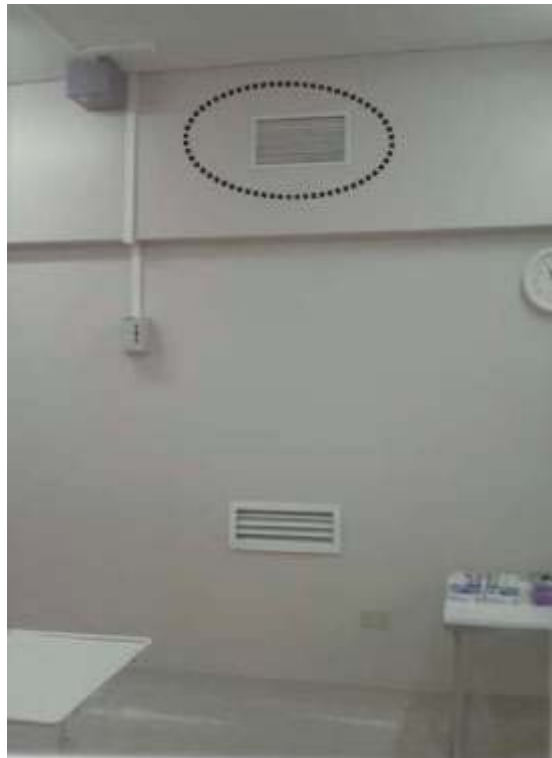
Fotografía 4. Rejillas circulación del aire
